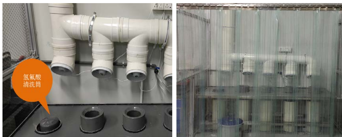
图 5-1 项目清洗线及氢氟酸清洗筒
