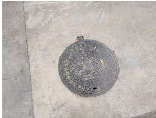
项目污水井盖
